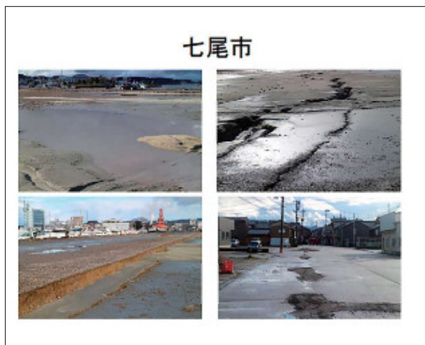
図-31 七尾市の被害状況①
