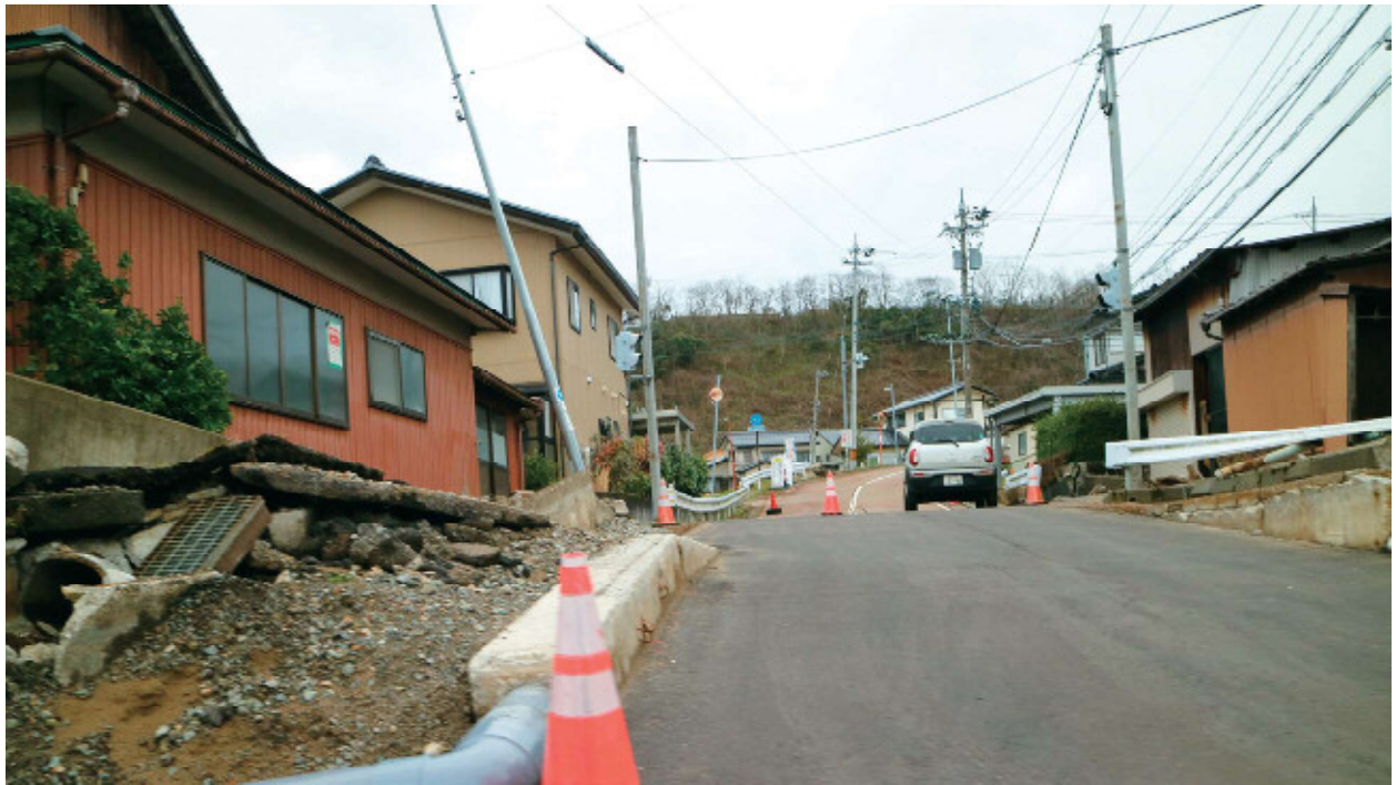
内灘町西荒屋地区の液状化被害 同上。(2024年2月中旬、カメラ撮影)
