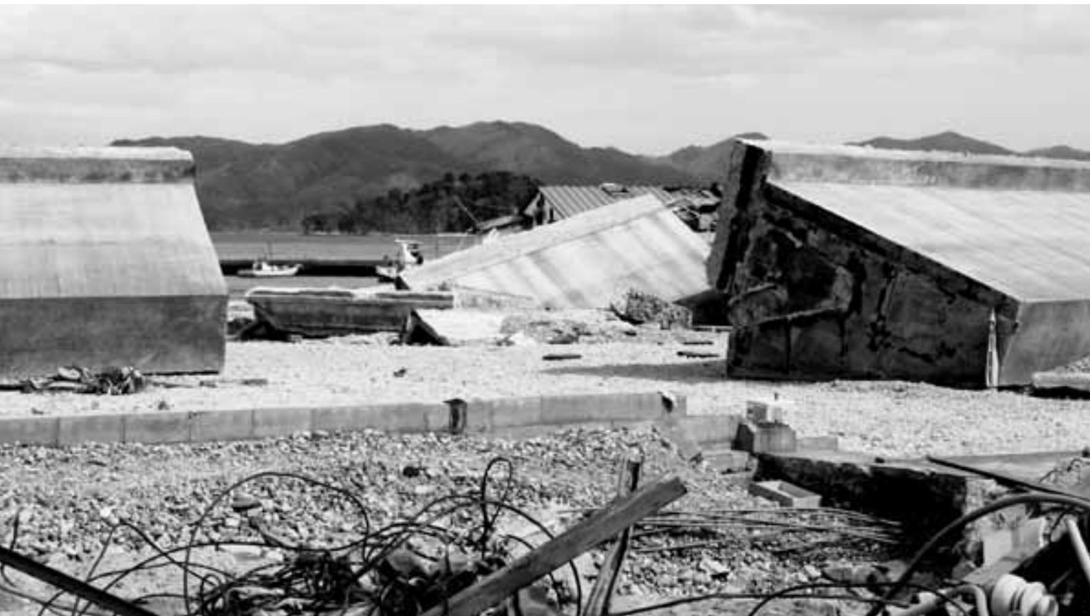
破壊された防潮堤（岩手県山田町：4月8日撮影）
